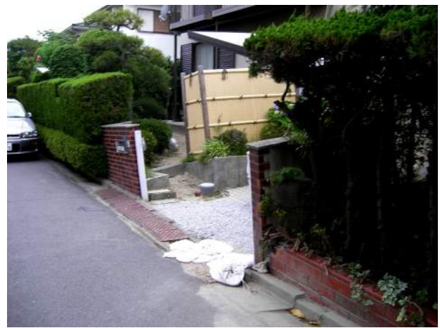
写真 4 浦安市の宅地被害 (家屋まわりの液状化・沈下の跡 (徳田兄撮影))
