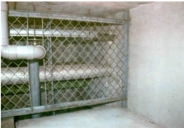
写真1 マンション床下配管の損傷跡
