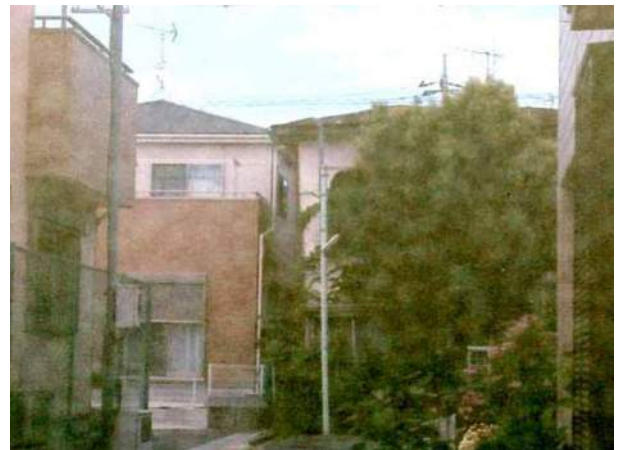
写真2 側方流動による家屋傾動(中央)
