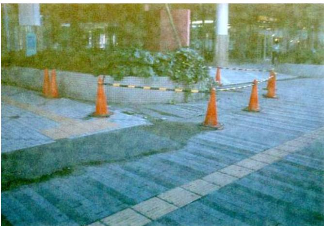
写真 3 幕張のホテルアプローチの液状化・沈下跡の跡
